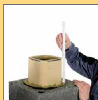
20. Відміряти потрібну довжину керамічної труби так, щоб керамічне облицювання гирла димоходу було на 1 см вище накривної плити.
