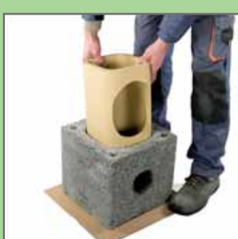
1. На шар ізоляції встановити пустотілий блок з вирізаним отвором для відведення конденсату, встановити в ньому цокольную трубу.
