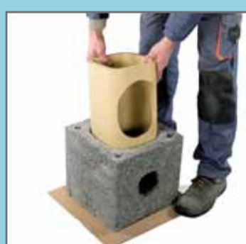
1. На шар ізоляції встановити пустотілий блок з вирізаним отвором на відведення конденсату, установити в ньому цокольную трубу.
