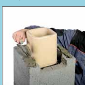
28. Накласти розчин на пустотілий блок з вирізаними отворами. Щілини або отвори підведення повітря до печі повинні мати поверхню у 1,5 більшу, ніж поверхня радіусу труби виведення димохідних газів.
